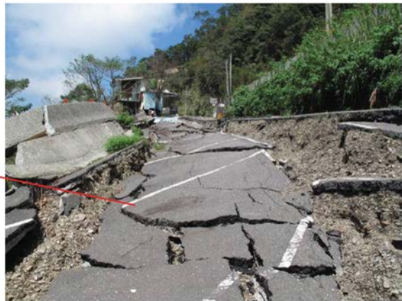
圖 16 莫拉克颱風藤枝地區崩滑破壞情形
